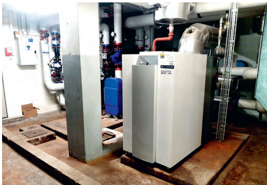
Echangeur de chaleur (CAD) et la chaudière à gaz
